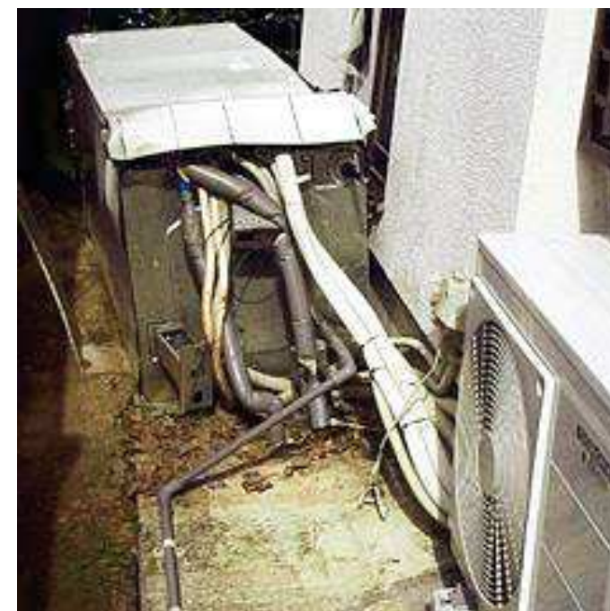
【熊本地震で転倒した電気給湯機】
