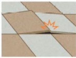
床タイルの浮き
