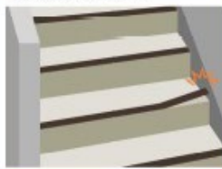
階段の滑り止めの浮き
