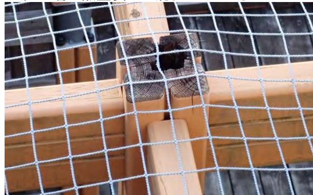
c. 柱上端が無塗装で空洞化しているもの
