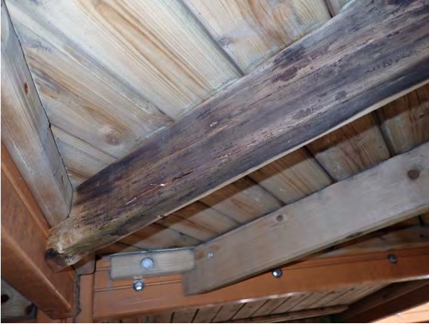
a. 腐朽の終盤状態の根太(区画032)
