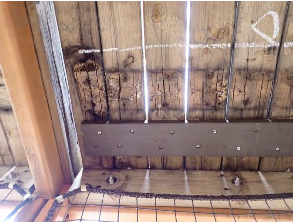
c. 床板の棧と接していた部分の腐朽(052)
