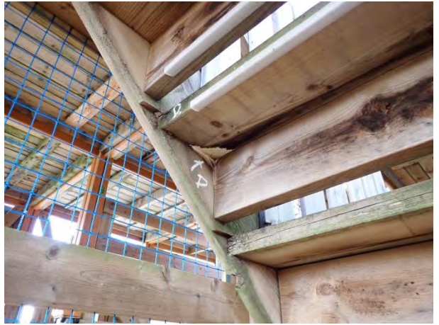
d. 階段踏板裏面の腐朽(082)
