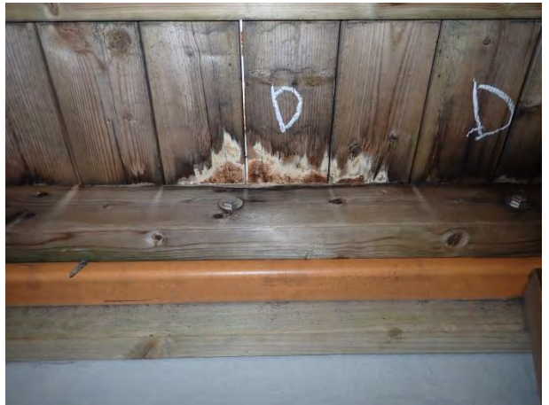
f. 床受け木と床板の腐朽(002)
