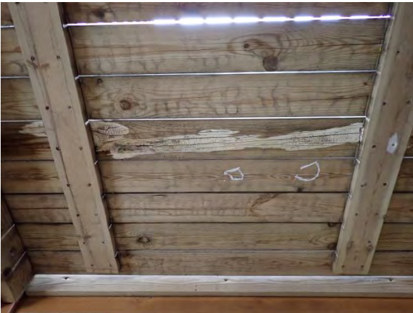
e. 床板の腐朽(108)
