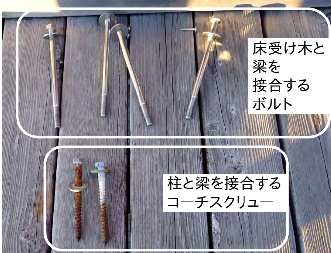
c. 接合に使用されていたボルトとコーチスクリュー
