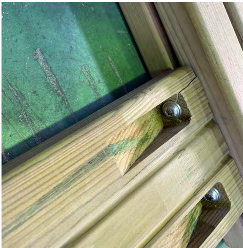
実験後の試験体（引張筋交い柱―梁接合部）：モーメント接合で引張側に割れが発生
