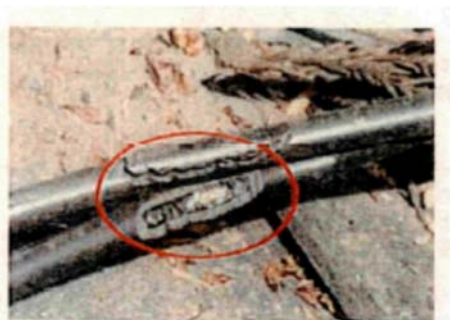
写真A.6 小動物が噛んだと思われる損傷箇所
