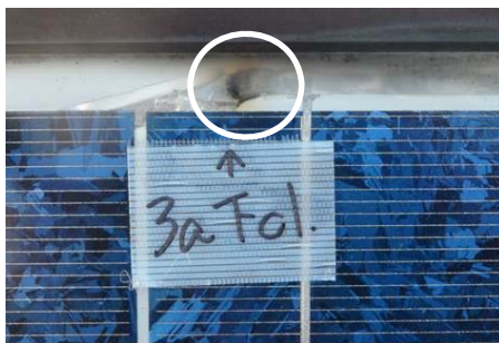
写真7 配線接続部の変色箇所 （モジュール表面）
