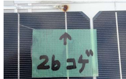
写真6 配線接続部の変色箇所 (モジュール表面)
