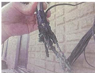
写真A.2 焼損したアレイケーブル
