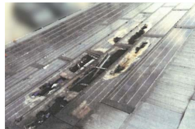
写真 A.18 屋根被災状況
