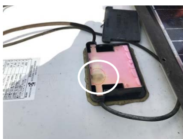
写真 9 バイパス回路の変色箇所 （端子ボックス内部）
