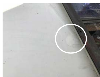
写真 10 バックシート膨れ箇所 （モジュール裏面）
