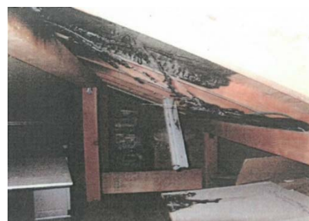
写真A.7 屋根裏の被災状況
