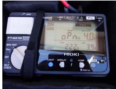
写真C. 1 バイパス回路検査装置（断線故障を検知したところ）
