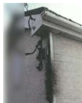
写真A.16 被災状況 (焼損ケーブル除去後)
