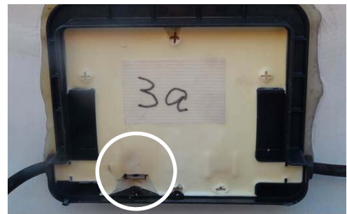
写真8 バイパス回路の変色箇所 （端子ボックス内部）
