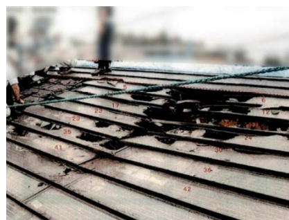
写真A.8 屋根の被災状況
