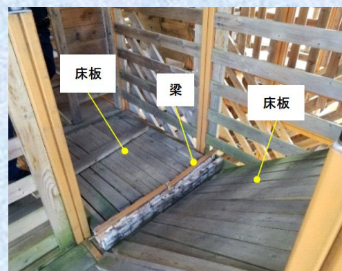
梁と床板が落下した直後の状態
