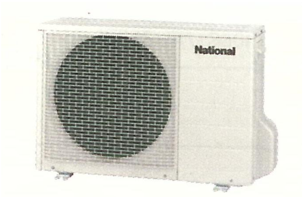
エアコン（室外機）（管理番号：A201100388）
