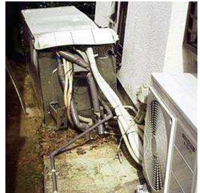
【熊本地震で転倒した電気給湯機】
