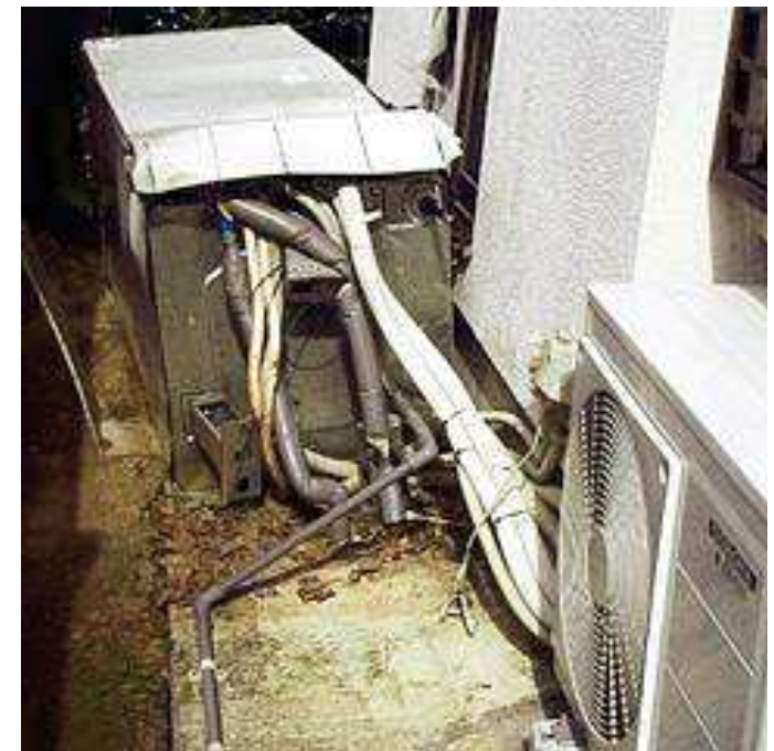
【熊本地震で転倒した電気給湯機】
