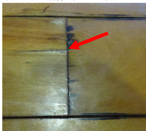
図11 短辺部分に発生した割れ
