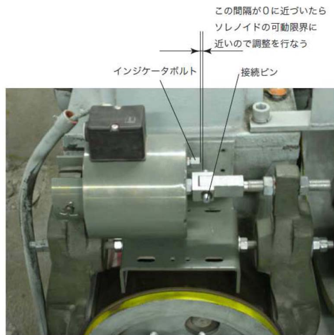
写真 事故機と同形式のブレーキ部分
